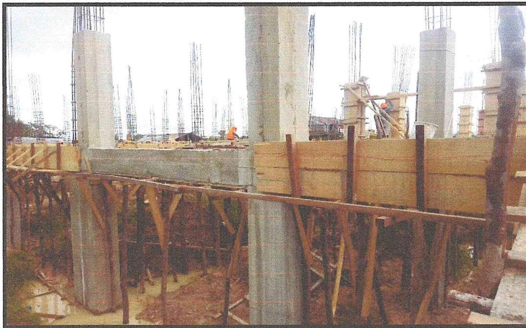
IMAGEN N°06: SE EVIDENCIA TRABAJOS DE DESENCOFRADO DE VIGAS Y COLUMNAS DE LA I.E
