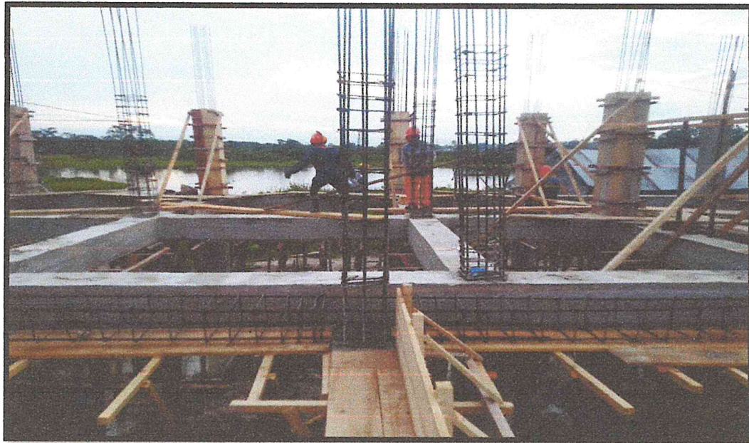
IMAGEN N°09: SE PUEDE APRECIAR TRABAJOS DE DESENCOFRADO DE VIGAS Y A LA VEZ SE MUESTRA LA HABILITACION DEL ACERO DE REFUERZO EN LA MISMA
