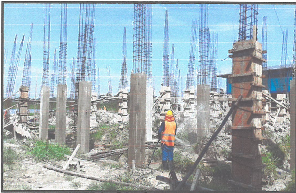
IMAGEN N°06: EN LA FOTO SE EVIDENCIA LOS TRABAJOS DESPUES DE HABER VACEADO MORTERO F'C=210 KG/CM2 EN COLUMNAS.
