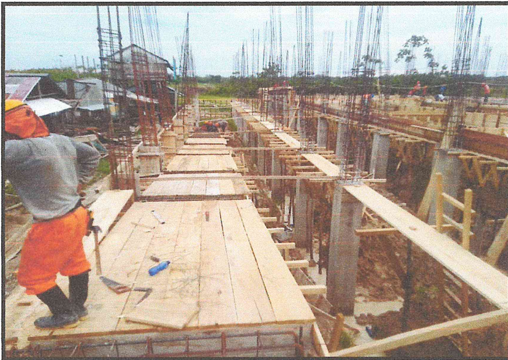
IMAGEN N°08: EN LA FOTO SE OBSERVA TRABAJOS DE ENCOFRADO PARA LA RAMPA DE ACCESO DE LA I.E
