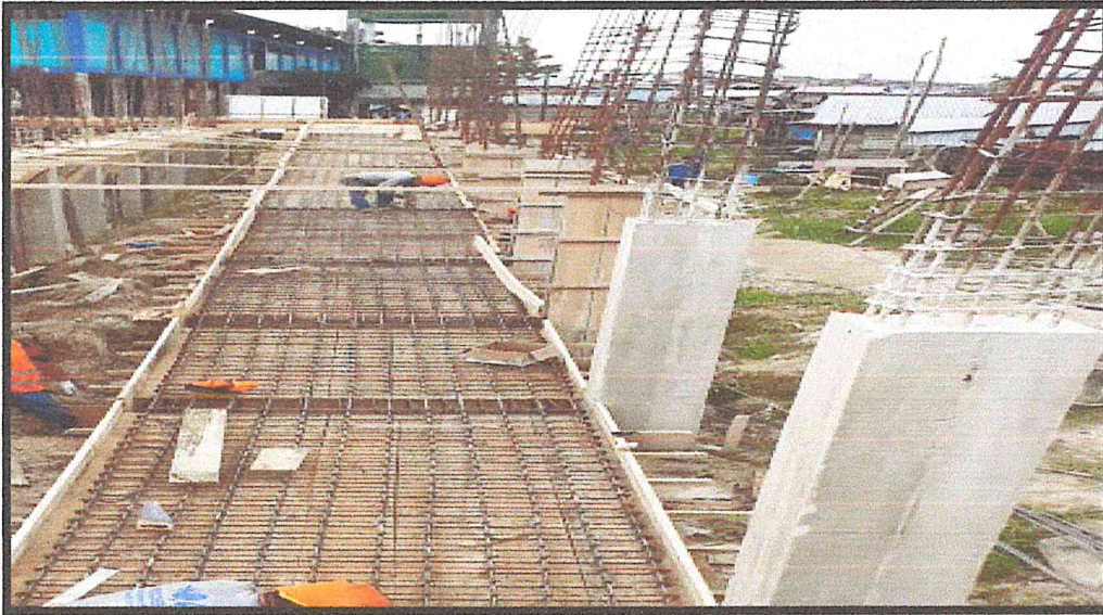
IMAGEN N°07: SE MUESTRA LA HABILITACION DEL ACERO DE REFUERZO EN LA RAMPA DE ACCESO DE LA I.E
