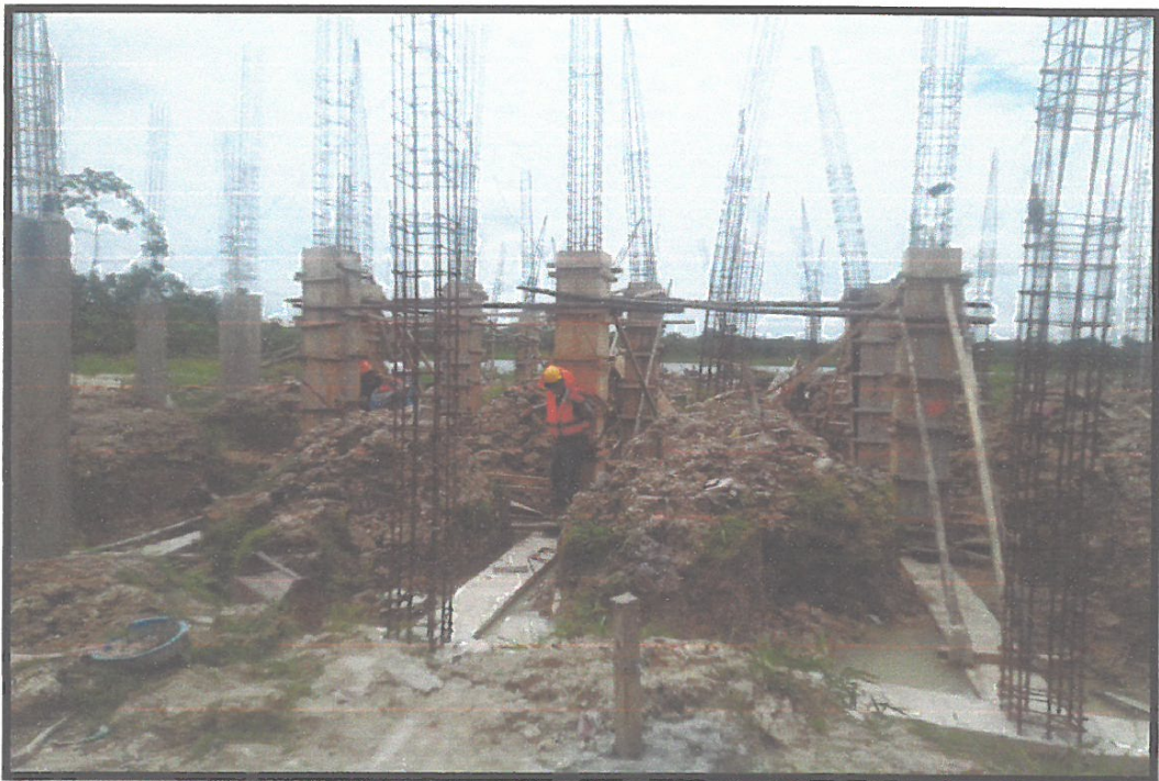
IMAGEN N°04: EN LA IMAGEN SE EVIDENCIA TRABAJOS DE HABILITACION DE ACERO DE D=1/2" EN COLUMNAS
